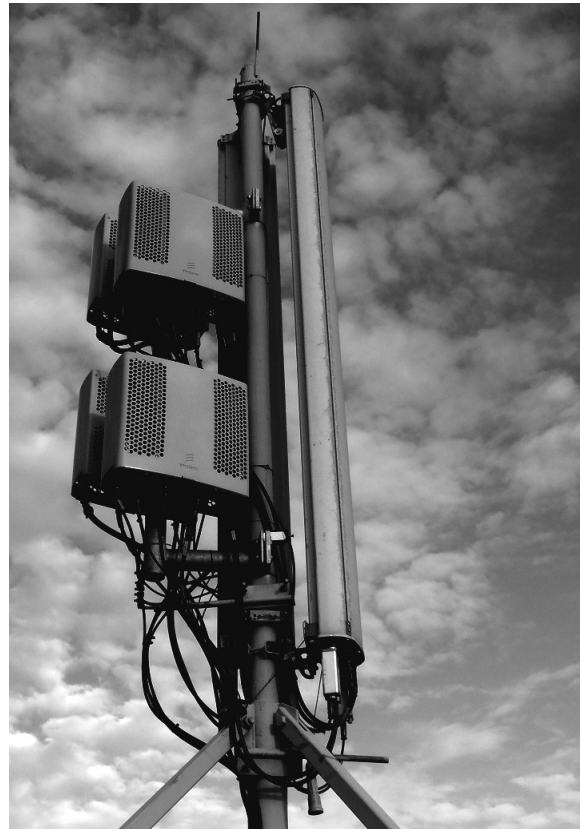
Fot. 2. Stacja bazowa z „plecakowymi” modułami radiowymi Photo 2. The base station with small remote radio units
