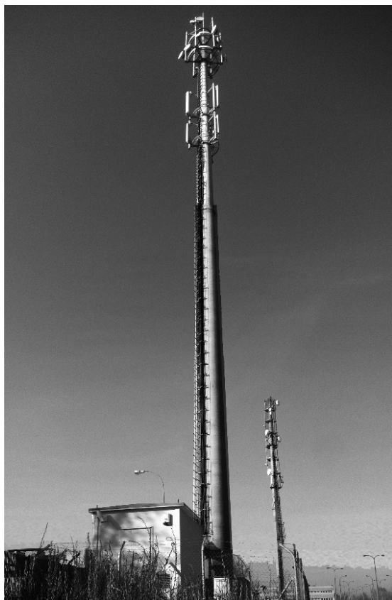
Fot. 1. Stacja bazowa starszego typu z układami nadawczo-odbiorczymi w kontenerze i długimi fiderami Photo 1. The base station with a transceiver placed in a container and long feeders
